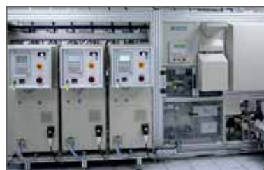
Voll automatisierte Multi-Batch Mikrowellen Kammeranlagen zur Trocknung von Filterkuchen unterhalb 0.1 % Restfeuchte
