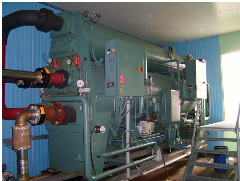
Abbildung 6: Blick auf die eingesetzte Absorptionskältemaschine [12]
